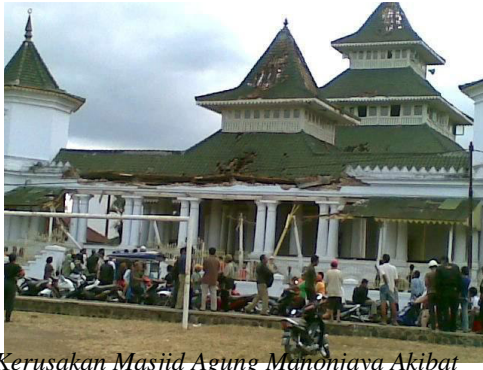
Kerusakan Masjid Agung Manonjaya Akibat Gempa Tahun 2010
