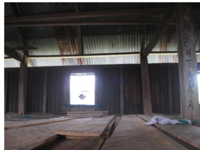
Foto: Lantai tiga dengan papan yang tidak beraturan serta jendela yang tanpa daun jendela.
